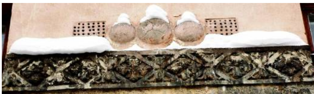
Ēka Krāsotāju ielā Nr. 11, celta 1912. gadā, arhitekts Roberts Donbergs. Fasādes dekoratīva ornamentāla josla. 2011. gads.
