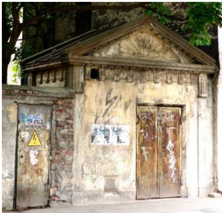
Augstsprieguma 6000/380/220 voltu transformatoru betona māja (kiosks) Krāsotāju ielā starp ēkām Nr. 9 un 11, celta 1912. gadā. 2012. gads.
