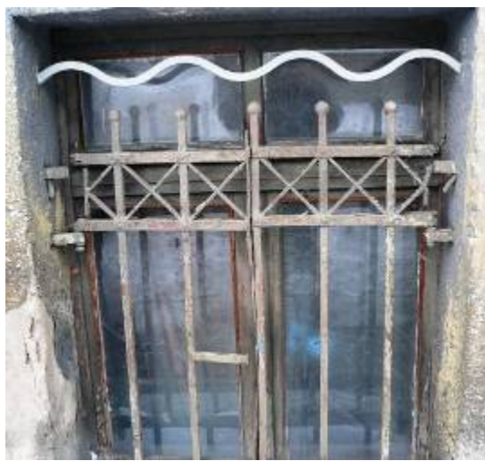
Ēka Krāsotāju ielā Nr. 9, celta 1912. gadā, arhitekts Pēteris Ladigins. Pagraba logu aiju restes. 2011. gads.
